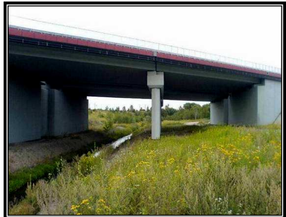
Fot. 11.9 Przejście dolne zespolone z ciekim dla zwierząt średnich (autostrada A4, okolice Gliwic)
