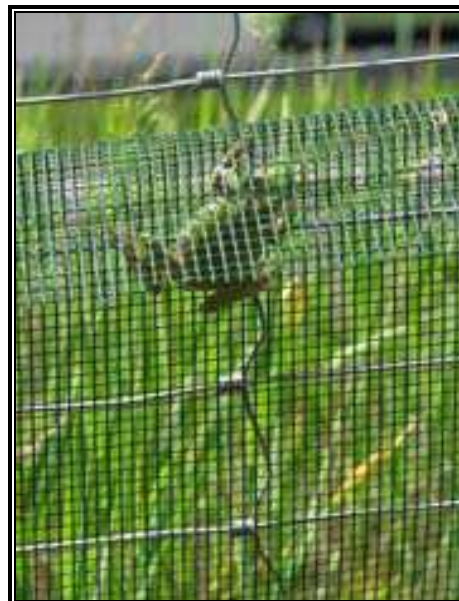
Fot. 11.17 Siatka zabezpieczająca płazy przed wejściem na jezdnię [126]
