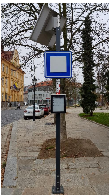
Obrázek 24: Zastávkový označnick zastávky Budovcova
