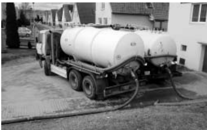
Obr. 10: Odčerpávání odpadních vod na ulici, Znojmo
