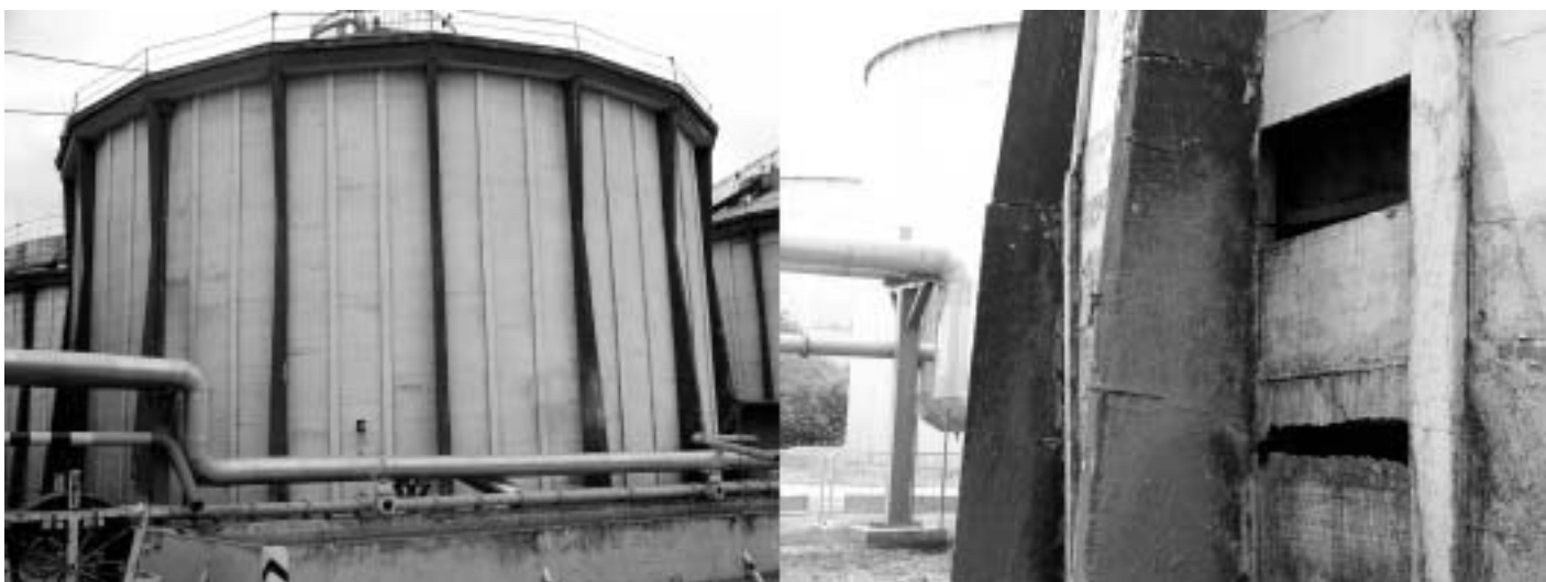
Obr. 1: Vyhnívací nádrž 1. stupně – původní opláštění a destruovaná část po havárii VN 7
