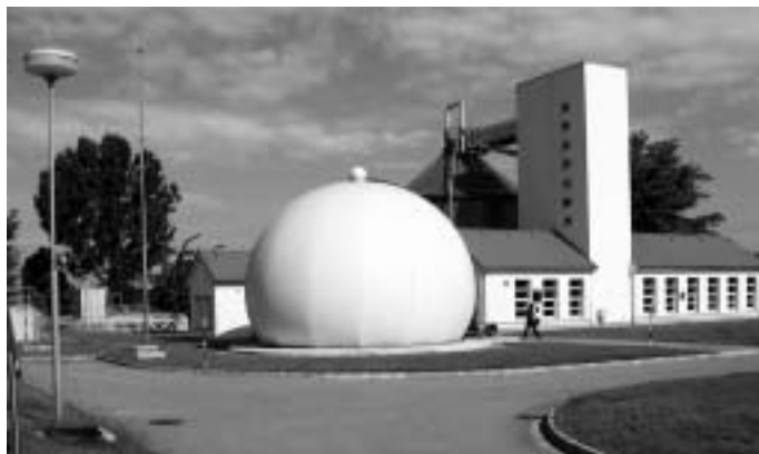
Plynové hospodářství ČOV Břeclav
