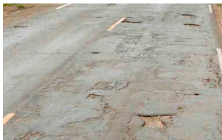
Calzada en mal estado.
