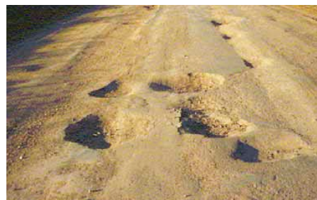
Calzada en muy mal estado.
