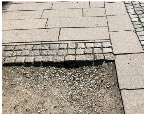
Bild 7. Ojämnt underlag på grund av sättningar eller slitage kan utgöra hinder och öka risken att snubbla.
