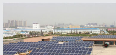
蕪湖廠區金太陽工程 -1.53MWp
