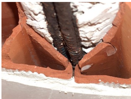
Figura 35: Mancato avvolgimento delle barre d'armatura dei travetti.
