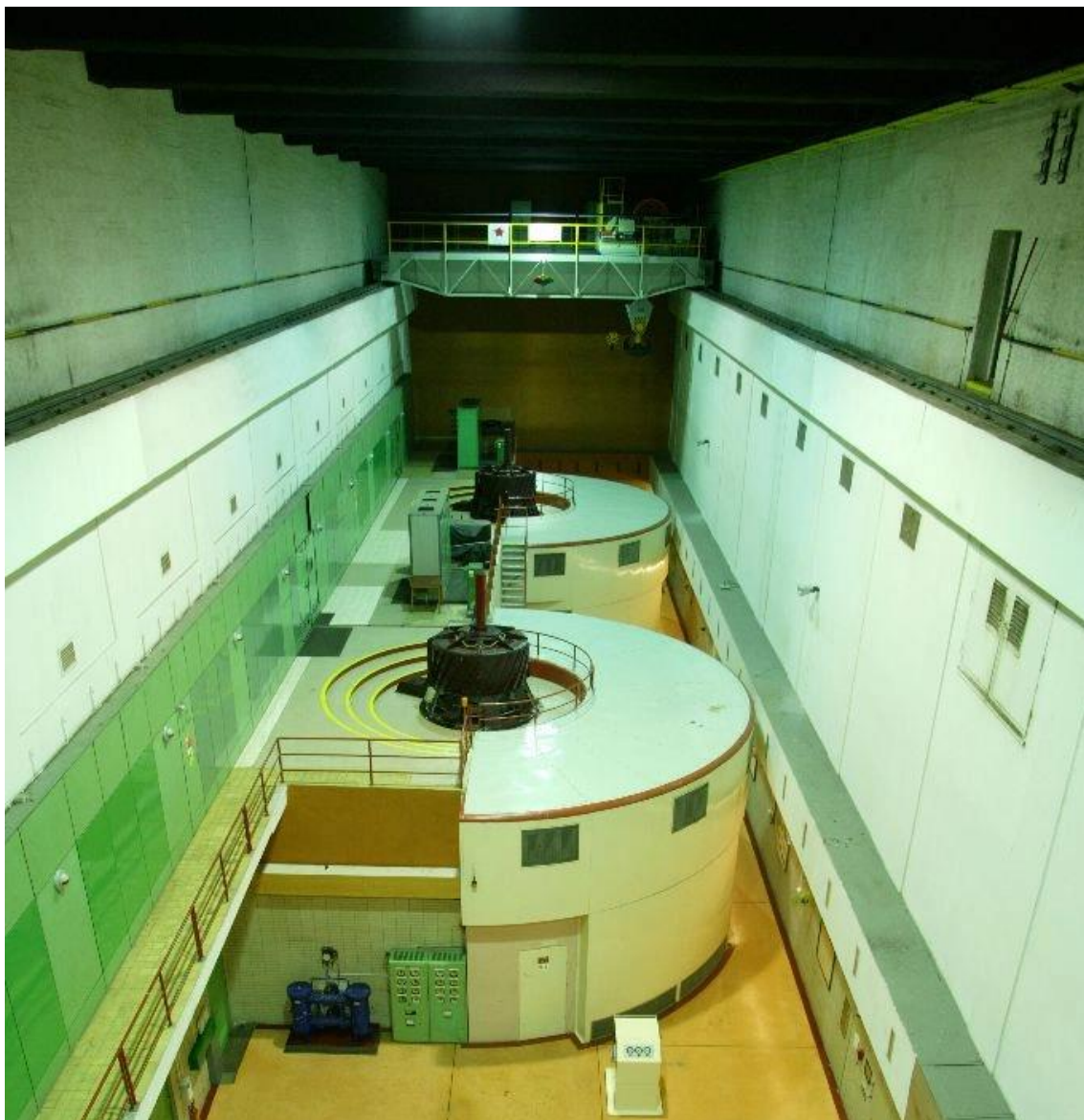
Obr. 2.2 Strojovna elektrárny Lipno I [8].
