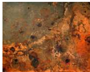
Obr.8: Nejznámější forma koroze [8]
