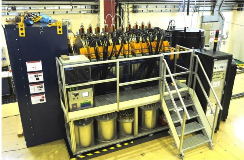
Figure II.11 : Vue d'ensemble du générateur LTD.
