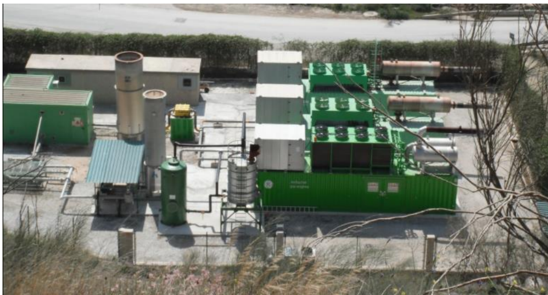
Figura 51, Foto dell'impianto elettrico a biogas. Fonte: http://www.limasa3.es/noticias/la-produccion-de-electricidad-en-el-centro-ambiental-es-noticia (in spagnolo)
