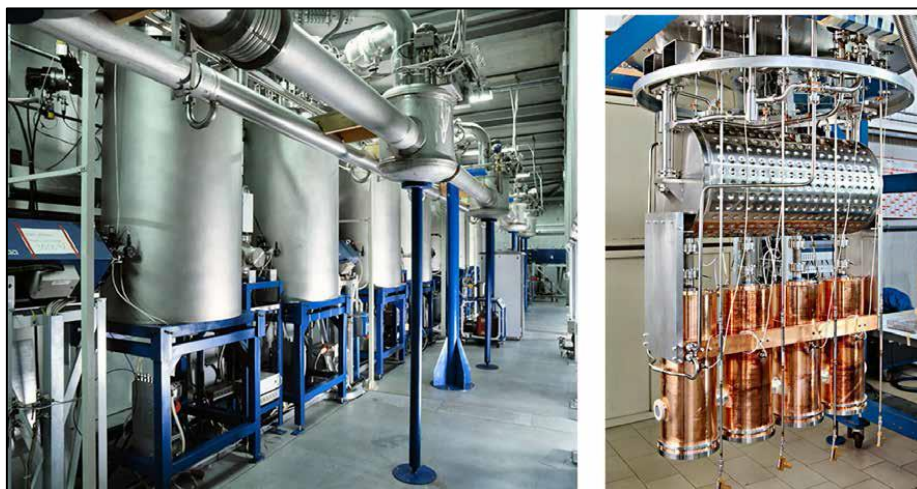
Fig. 1.16 A sinistra, un tratto del linac ALPI. In evidenza i criostati, recipienti che contengono ed isolano termicamente le cavità superconduttive (a T=-269 °C). A destra, l'interno di un criostato, con 4 cavità acceleranti su base di rame.
