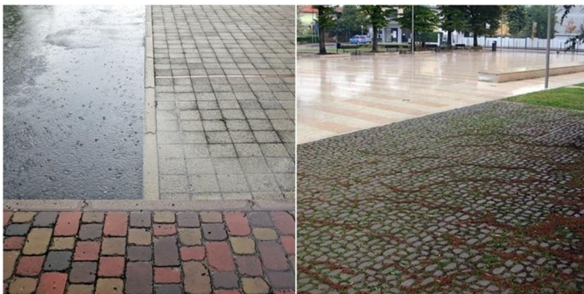
Immagine 4 - L'acqua scorre sulle superfici impermeabili andando a invadere gli spazi adiacenti
