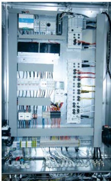
Rozvaděč s ventilovým terminálem CPX MPA-L s komunikací Ethernet/IP.
