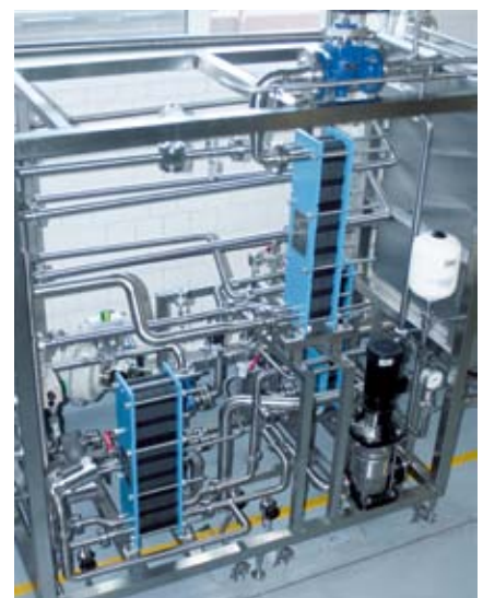
Výměňková stanice jednotky UHT.
