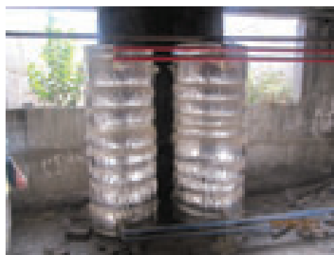
Изоляция на теплообменнике на входе теплораспределительного пункта здания судебной медицины в Ташкенте
