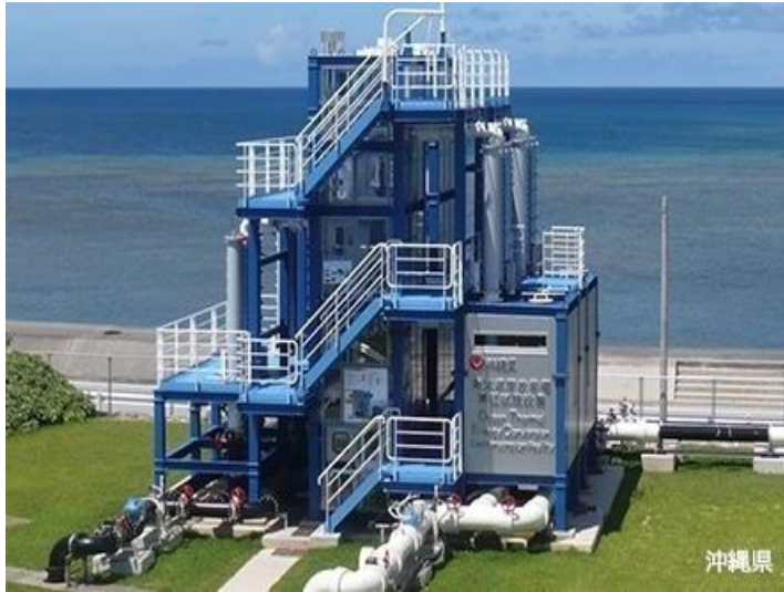
Kumejima OTEC plant, Japan
