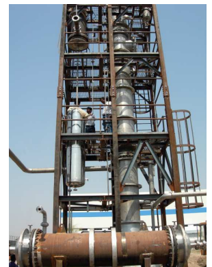
Figura 4.2. Torre de secado
