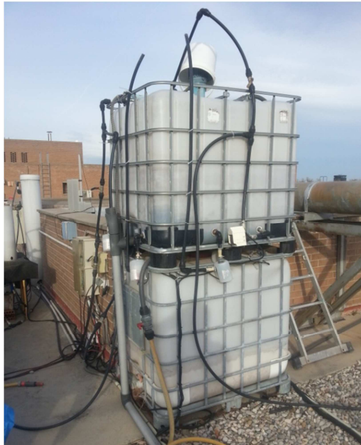
Figura 19: Tanque de abastecimiento de agua residual.
