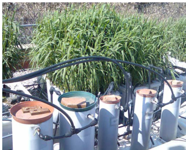
Figura 21: Decantadores del tratamiento primario.
