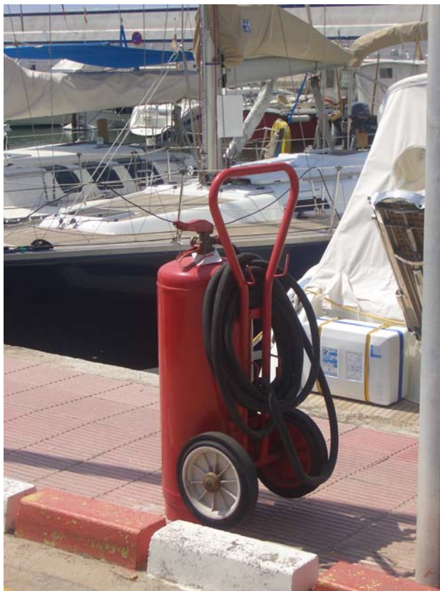
Figura 31: Extintor (Club de Vela Blanes)
