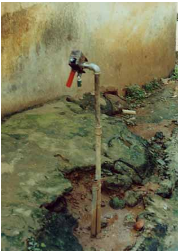
Punto de venta de agua perteneciente a un vecino. Barrio de Melen IV. Yaundé. Camerún. Fuente: Magrinyà, 2001
