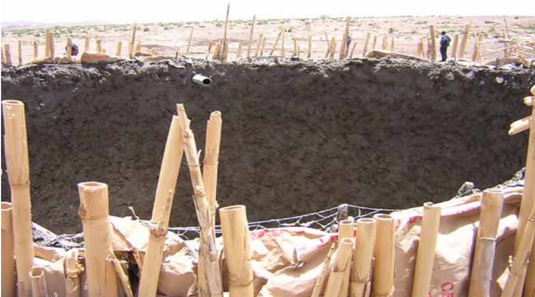
Tanque de almacenamiento de agua de lluvia en ferrocemento. Fuente: ESF-INTERMON Etiopía (2003)
