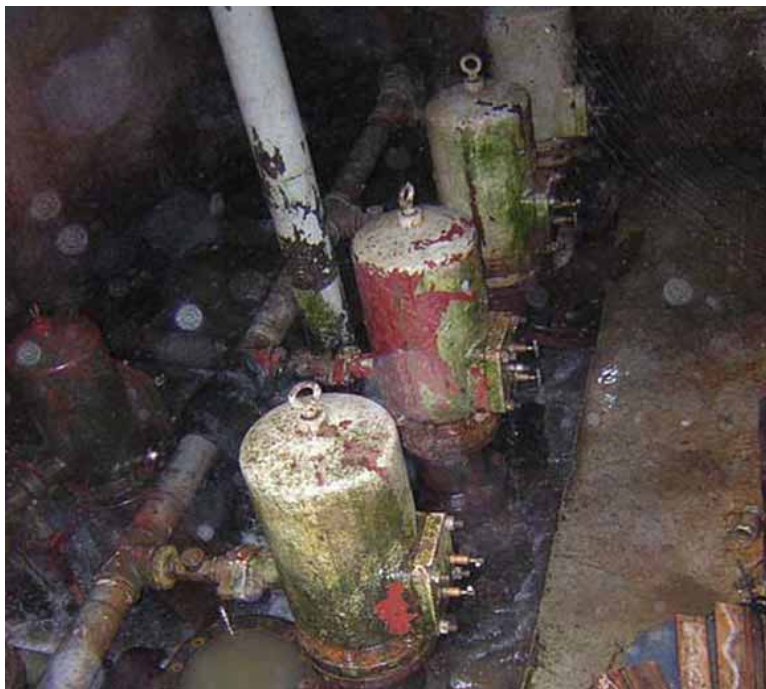
Bombas de golpe de ariete conectadas en paralelo (Rift Valley – Etiopía). Fuente: Manual de Criterios Técnicos para Proyectos de Agua en Etiopía. INTERMON - ESF
