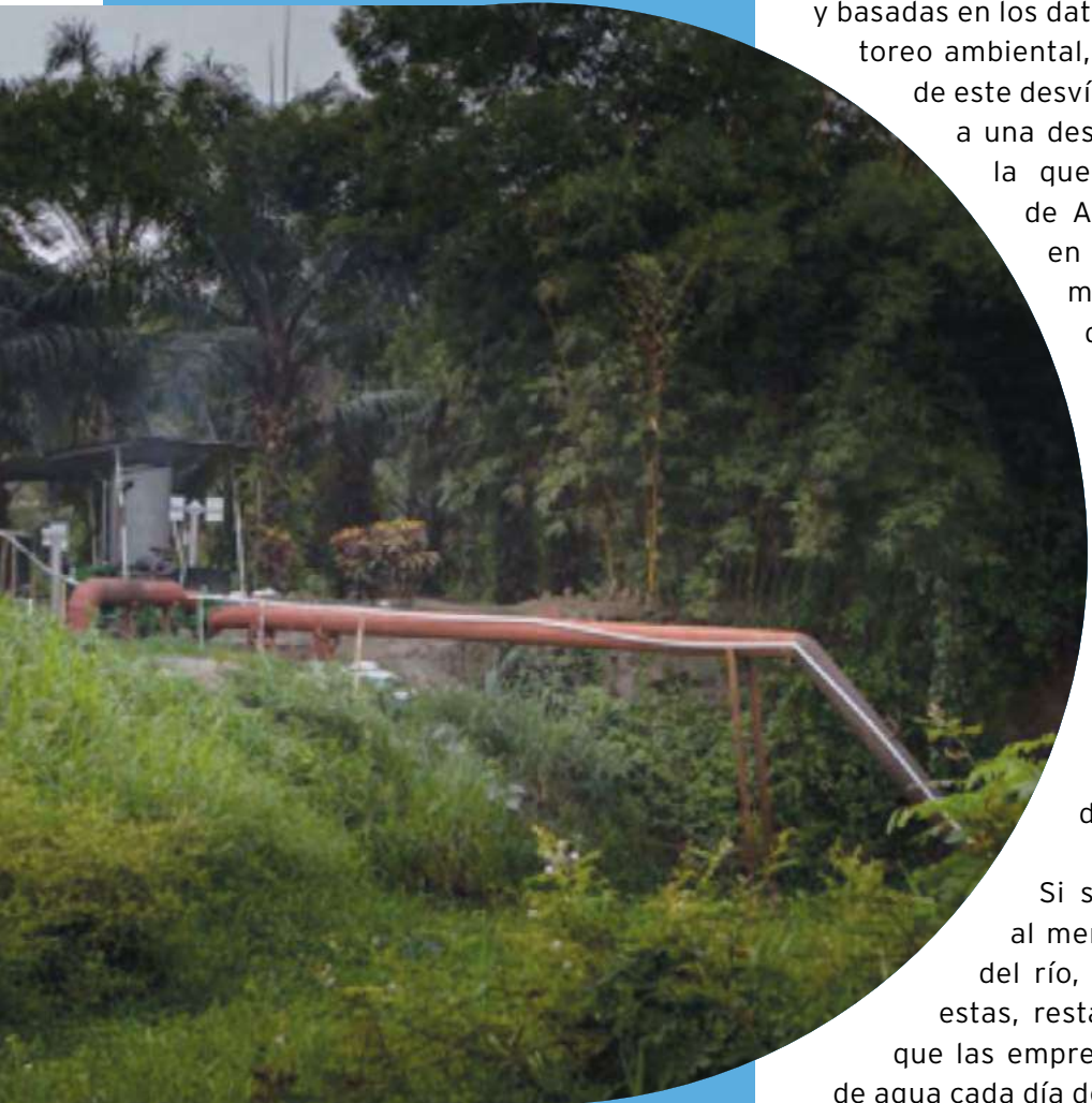
Figura 20: Captación de agua con bomba desde el Río
