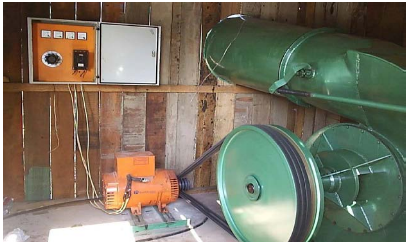
Esta turbina microhidroeléctrica y generador trajo electricidad y entusiasmo a una comunidad remota en Brasil. 2006.
