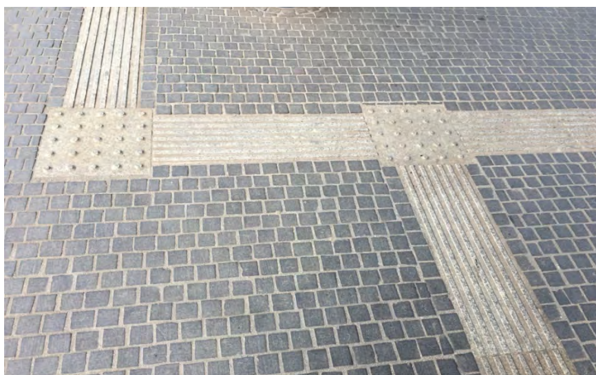
zdj.5 elementy ostrzegawcze i prowadzące na peronie 2.- Gdańsk Wrzeszcz
