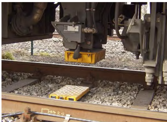
Rysunek 21: Współpraca balis rozłożonych na torach z urządzeniami odbiorczymi na pociągu (źródło: Siemens) [24]
