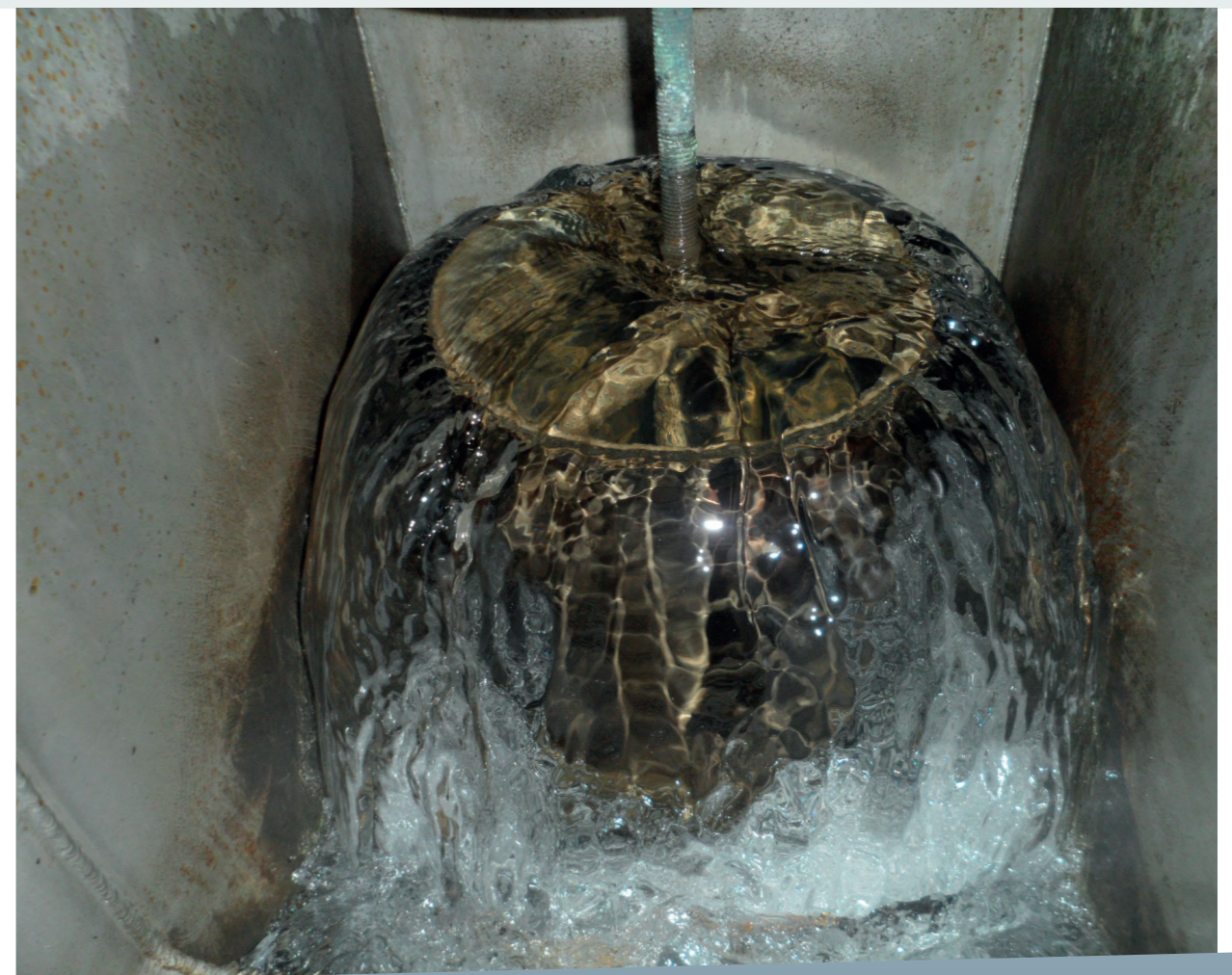
Effluent sortant d'un flottateur
