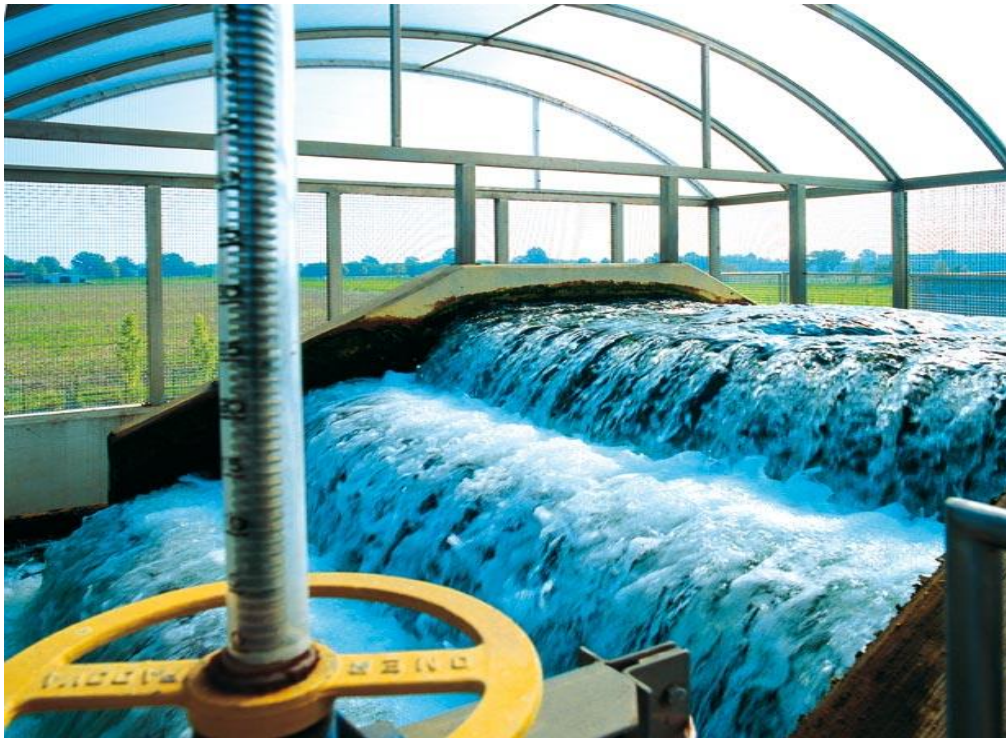
Figura 5. Impianto di potabilizzazione di Cremona: Ingresso dell' acqua dopo il sollevamento su un griglia a nastro
