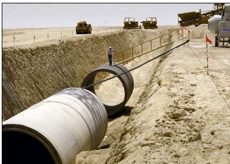
Obr.6 1100 km dlouhé potrubí o průměru 4 m pro dopravu vody přes poušť v Lybii (zdroj: J. Kotulič - Bunta)
