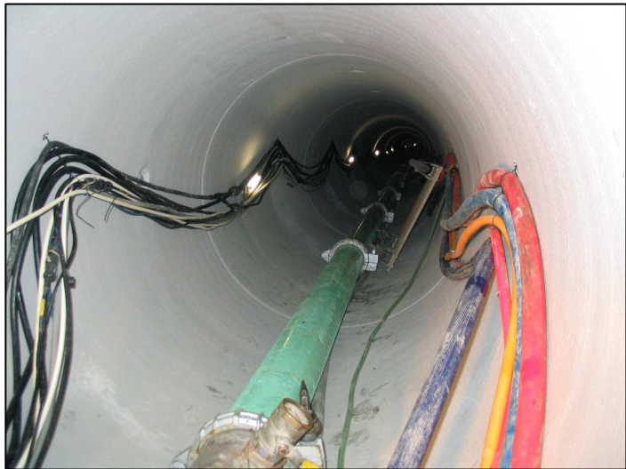
Obr.8 Pohled do potrubí vtačovaného do země cca 4 m pod povrchem. Provádí firma ..... v Japonsku. (Foto autor)
