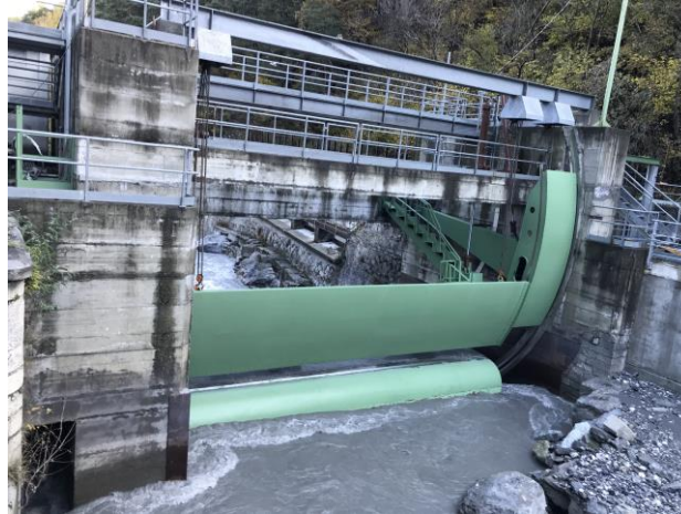
Figura 22: esempio di paratoia a controllo sita in impianto a Serre La Voute (Iren Energia).
