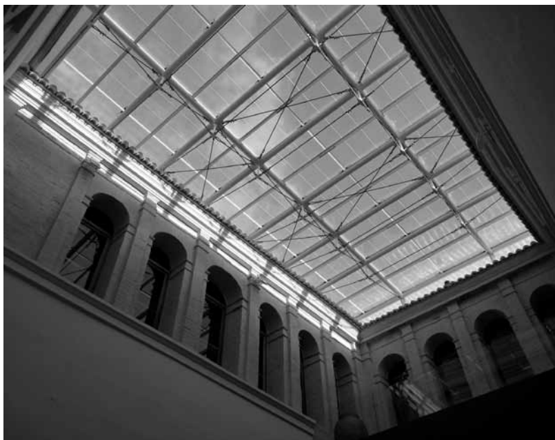
Figura 32. Cubierta acristalada del patio en la que se han colocado paneles fotovoltaicos translúcidos
