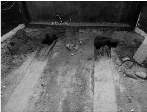
Figura 15. Estado de las vigas de madera que forman el forjado de suelo del salón noble
