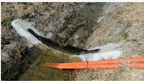
Stramazzo in opera nel canale di gronda
