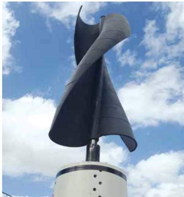
FIGURA 4: Turbina con generador instalada en la parte superior de un edificio.
