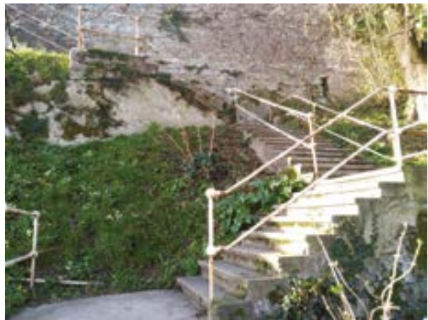
Figura 18. Perspectiva del pasamanos desprendido y su situación al pie de la escalera.
