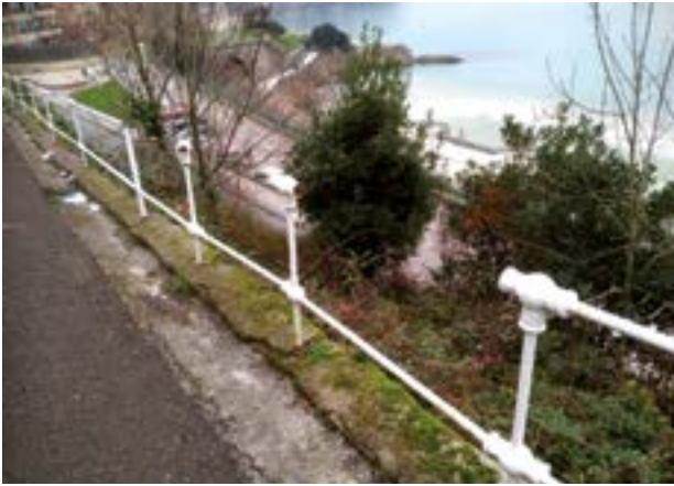
Figura 15. Faltan tres tramos del pasamanos de la barandilla original.
