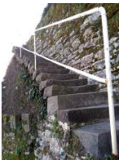
Figura 13. Peldaños en vuelo con escalones erosionados.
