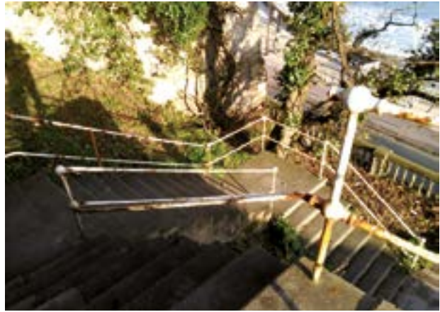
Figura 16. Localización del pasamanos desprendido.
