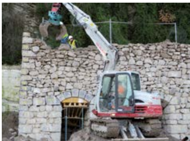
Proceso de reconstrucción del Horno calero de Latsuene (Donostia) en su nuevo emplazamiento.
