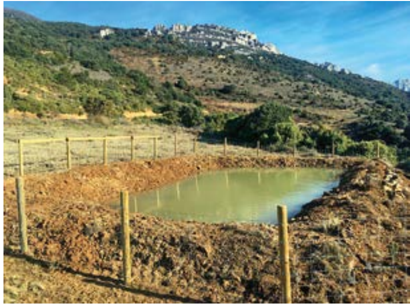
Encharcamiento recién construido en el municipio de Samaniego. 📷 G. GARCÍA DE MARCOS
