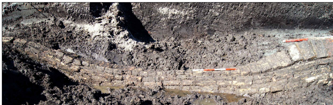
Afbeelding 58. De goot aan de buitenzijde van de kelder lag over een oude sloot. Door het inklinken van de kleivulling verzakte de goot in de loop der tijd.
