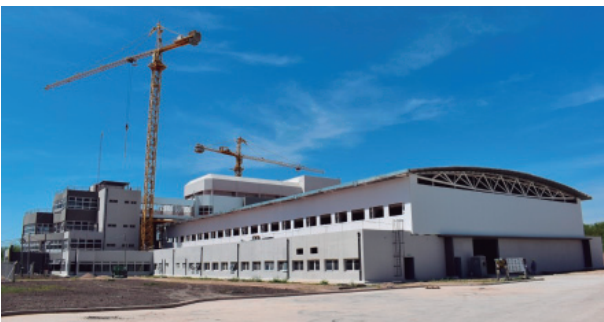
Reactor Multipropósito RA-10 en construcción en el Centro Atómico Ezeiza (Crédito CNEA, diciembre 2022)
