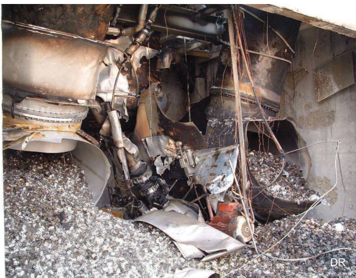
Colonnes endommagées remplies de catalyseur
