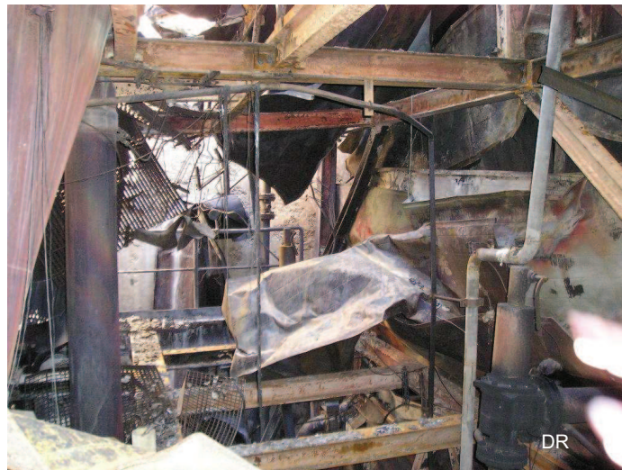
La « chambre froide » détruite
