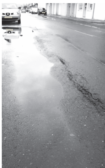
Afundimento do asfaltado na rúa Martagona
