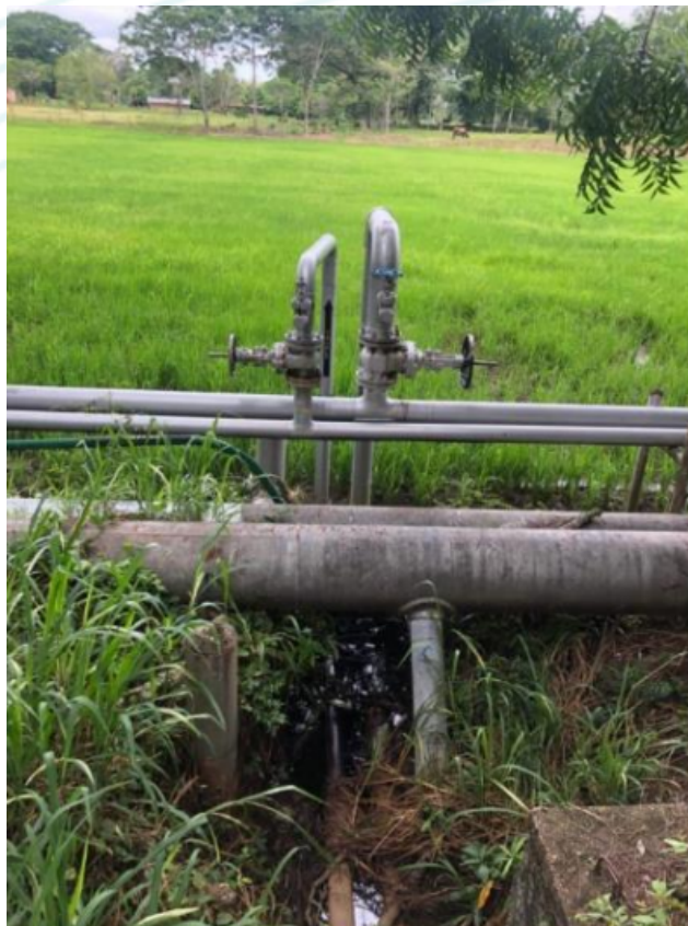
Derrame de 0,041 Bbls de Crudo por Pitting en accesorio T
