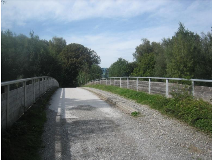
Fig. 2.2 Manufatto con marciapiede ricoperto da vegetazione (sovrappasso Fohlenhof A13 / foto: M. Trocmé).
