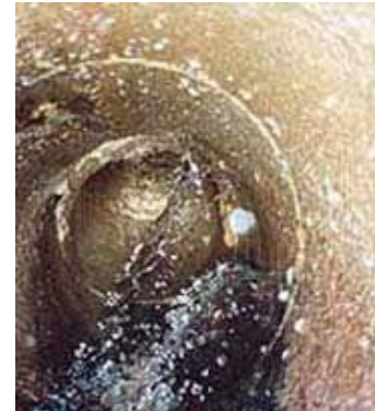
Fremdwasser im Kanal
