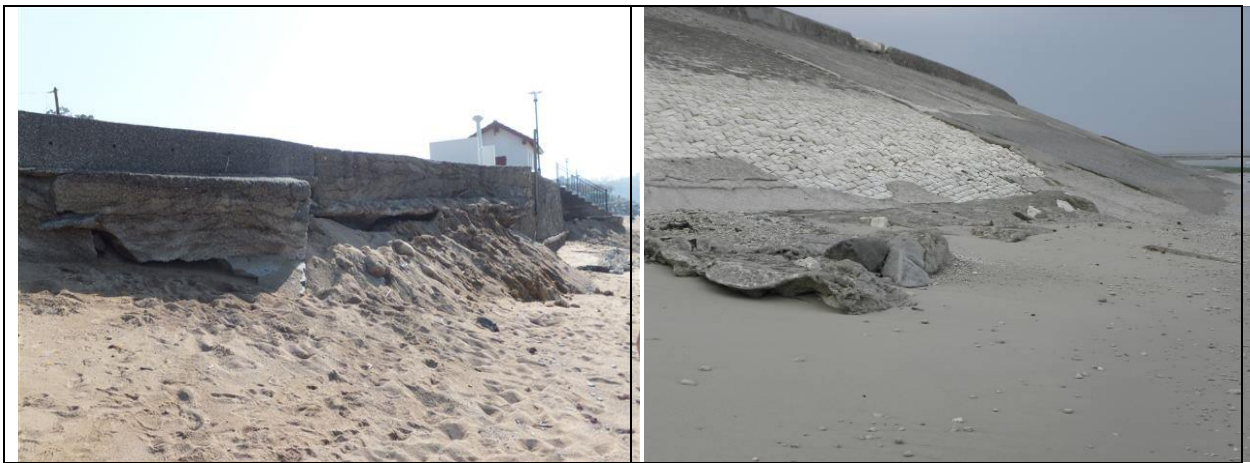
Figure 2.25 – a- Sous-cavage de la digue d'Erromardie -estran principalement sableux- Source Cerema ;b- Digue de Saint Clément des Baleines : Abrasion du perré et baisse du "platier" calcaire nécessitant un enduit sur le parement et des recharges en pied de talus - Source Irstea.
