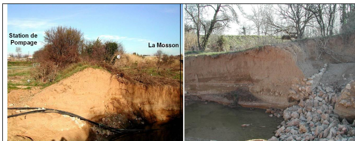
Figure 2.32 – Digue de la Mosson après la rupture : câbles mis en place dans la tranchée et restes de l'ancienne fondation – Source Cerema.
