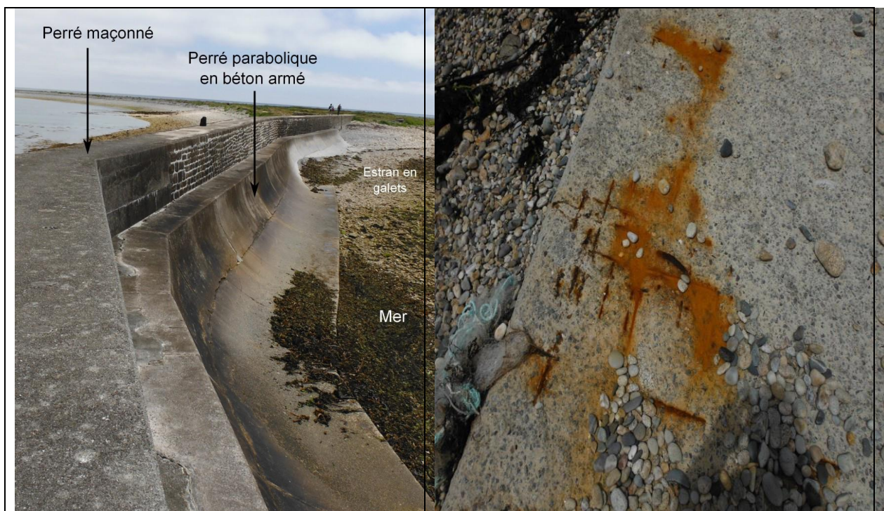
Figure 2.24 – Digue de Pors Kaïg : Exemple d'abrasion du béton par les galets - Source Cerema.
