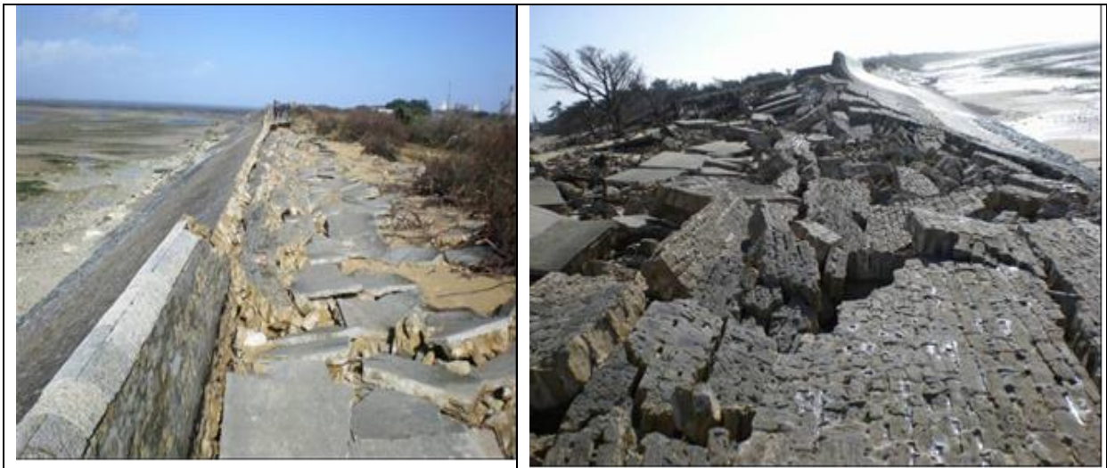
Figure 2.28 – Digue Ouest de Saint Clément des Baleines : Effondrement de la dalle de crête (photo a) qui peut se poursuivre par un effondrement de la protection en maçonnerie du talus jusqu'à formation d'une brèche (photo b) – Source DDTM 17.
