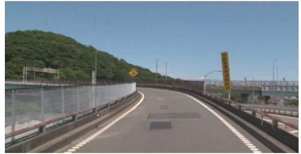
既存床版の損傷状況
