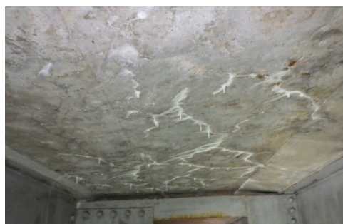
既存床版の損傷状況
