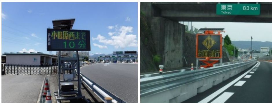
【簡易 LED 情報板設置状況】
