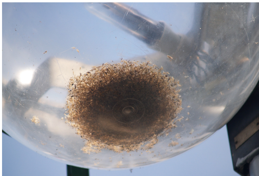
Překonaná, nevhodná konstrukce zdroje osvětlení způsobuje, že otvory odvádějící teplo vniká do difuzoru hmyz. Vrstvy mrtvých hmyzích těl výrazně snižují účinnost zdroje světla v místě, kam by naopak světlo mělo dopadat. Foto: Jan Kondziolka
