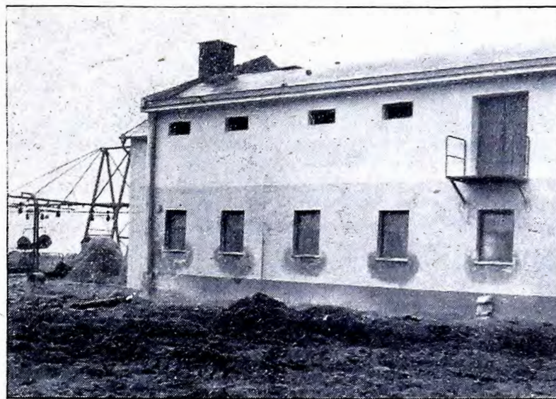
Obr. 1.: Jeden z důkazů špatné funkce větrání stájových prostorů - stále vlhká zóna zdiva kolem oken. (Novostavba kravína JZD Blatnička, Jižomoravský kraj). Foto autor.
