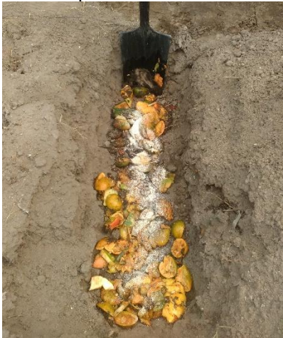
Figura 1. Preparación de camas a través de doble excavación, con aporte de Materia Orgánica fresca.
