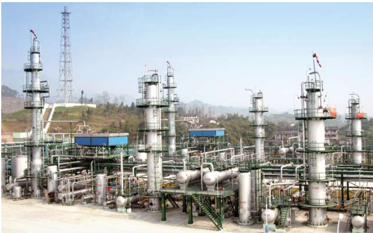
Очистительный завод природного газа (с применением растворителя селективной сероочистки СТ8-5)
