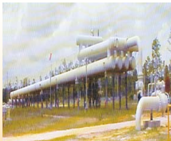
Жидкостный коллектор на входной трубе очистного завода
