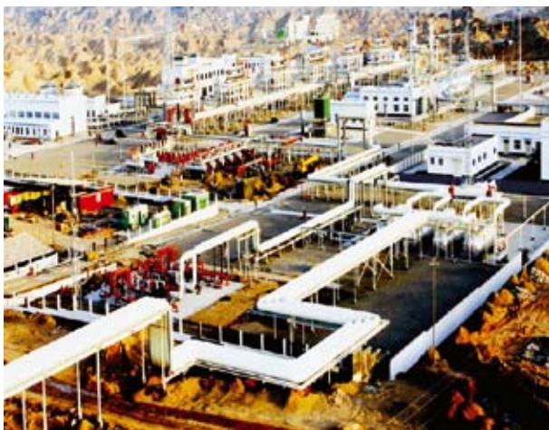
Центральный очистной завод на газовом месторождении Кэла-2
