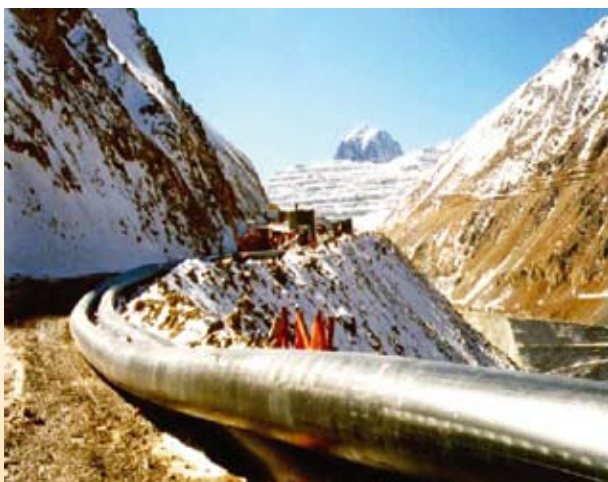
Трубопровод сбора и транспортировки смешанной газовой и жидкой смеси на месторождении Инмай-7
