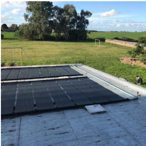
Figura 6: Colectores solares sobre el techo de la escuela.
