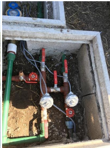
Figura 7: Caja de válvulas, sensores de temperatura y caudalímetro.
