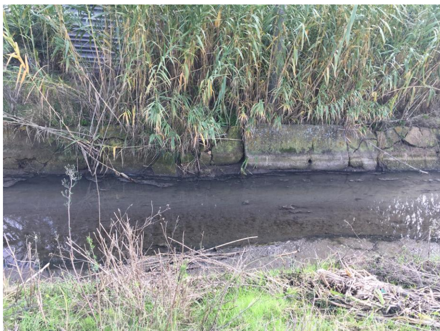
Figura 10 – Canale S.Lucia - Particolare stato di degrado delle sponde e presenza di fanghi sul fondo del canale
