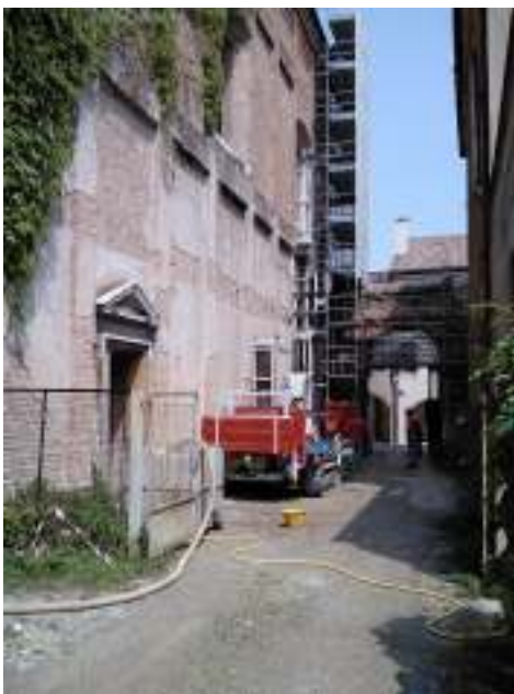
Esecuzione di sondaggio a carotaggio continuo alla profondità di 10 m presso cantiere a Treviso
