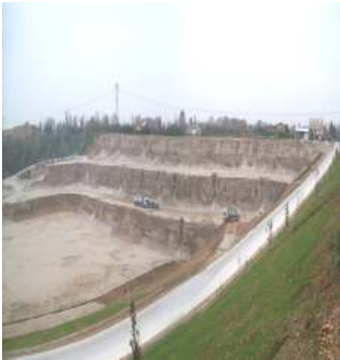
Discarica per rifiuti inerti in corrispondenza di cava di ghiaia in comune di Montebelluna (Tv)
