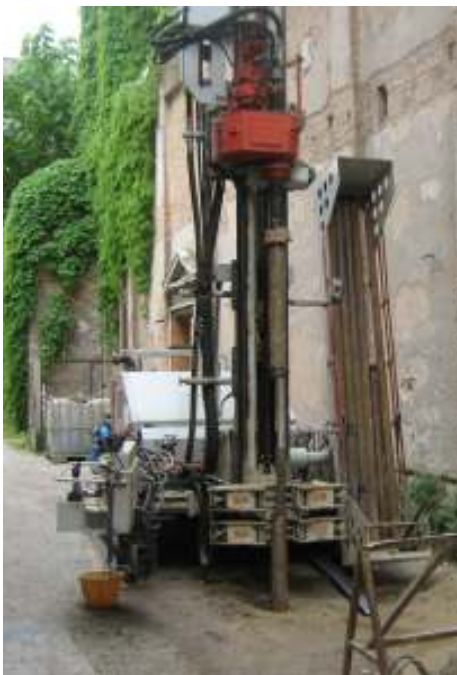
Esecuzione di sondaggi a carotaggio continuo, con corona diamantata, diametro di perforazione pari a 125 mm presso cantiere a Treviso
