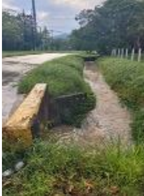
Fotografía 17 Box Coulvert existente para el manejo de aguas de escorrentía en la zona de la Glorieta El Cairo, obra colmatada (reemplazo estructura A6 – K5+000)
