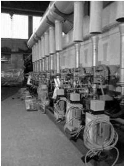
Ein Blick auf die Seite einer CBD-Anlage mit Gasvorheizung durch Rekuperatoren
