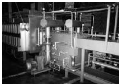
Schnellkühlzone mit zwei integrierten Kühlsystemen und externem Wärmetauscher
