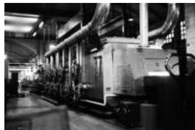
Ofeneinlasszone eines CBS-Ofens mit Abgaskamin
